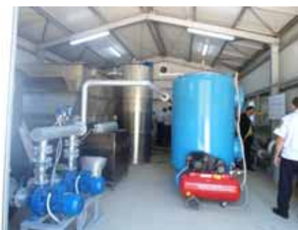
Stație tratare apă potabilă
